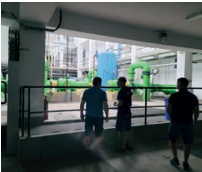
ÚV Tlumačov je zdrojem vody pro více než 170 000 lidí na Zlínsku
