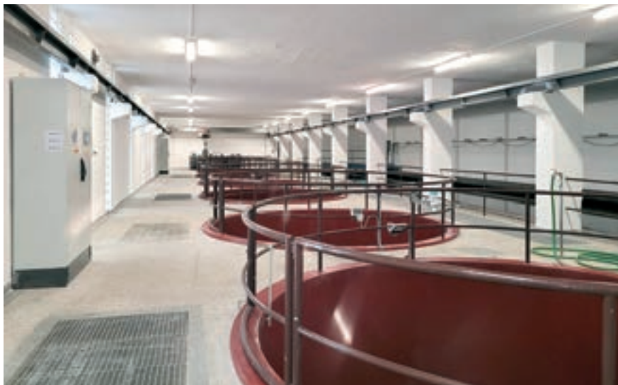
V Úpravně vody Tlumačov se k filtraci využívá aktivní uhlí
