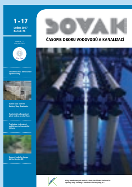
Bloky membránových modulů v hale ultrafiltrace karlovarské úpravně vody. Vodárny a kanalizace Karlovy Vary, a. s.
