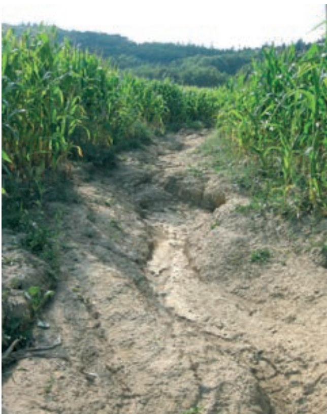
Obr. 1: Erozní rýha v dráze soustředěného odtoku (DSO) v povodí Luhy
