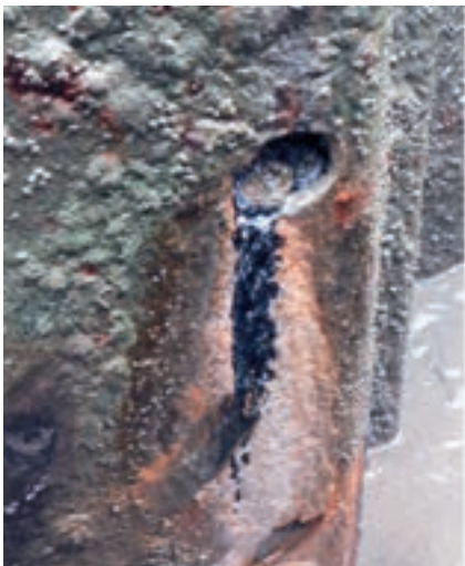
Díra na zemní straně kovové štetovnice způsobená mikrobiálně navozenou korozi
