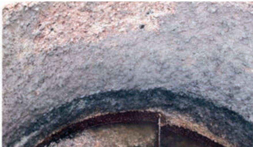
Degradace betonu v kanalizaci potravinářského podniku způsobená mikrobiálně navozenou korozi
