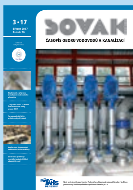
Nově vystrojená čerpací stanice Podmračí. Vodohospodářská společnost Benešov, s. r. o.
