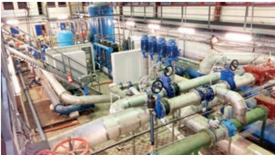
Obr. 9: Pohled do strojovny
