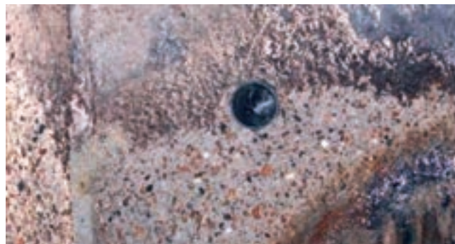
Ocelobetonový povrch napadený biokorozi s různou mírou koroze
