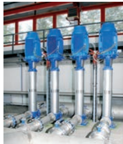
Obr. 10: Nová sestava čerpadel ČS Podmračí
