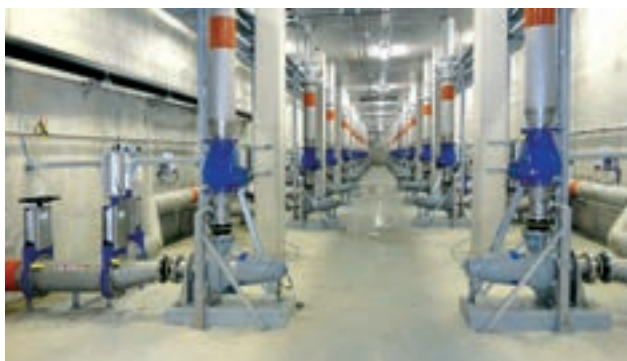
Dosazovací nádrže, čerpání kalu
