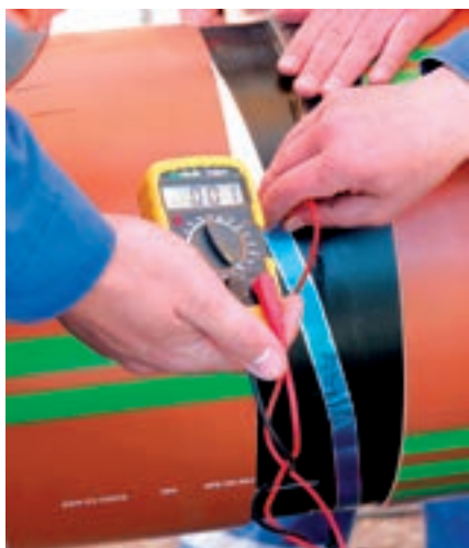
Kontrolní měření integrity potrubí
