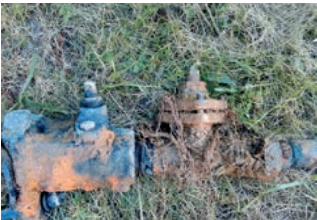
Demontovaný vadný přípojkový uzávěr s poruchou; PM – K Fořtovně 11
