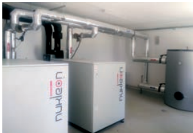
Tepelná čerpadla na jímání tepla z odpadní vody
