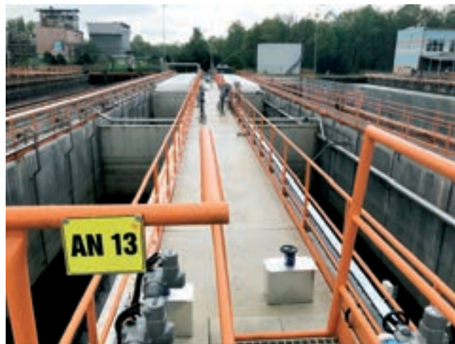
Obr. 5: Pohled na zmodernizovanou nádrž AN13 – čtyři reaktory pro čištění odpadních vod s vysokým obsahem amoniakálního dusíku
