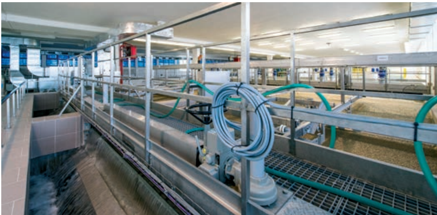
Odtok vody z flotační nádrže
