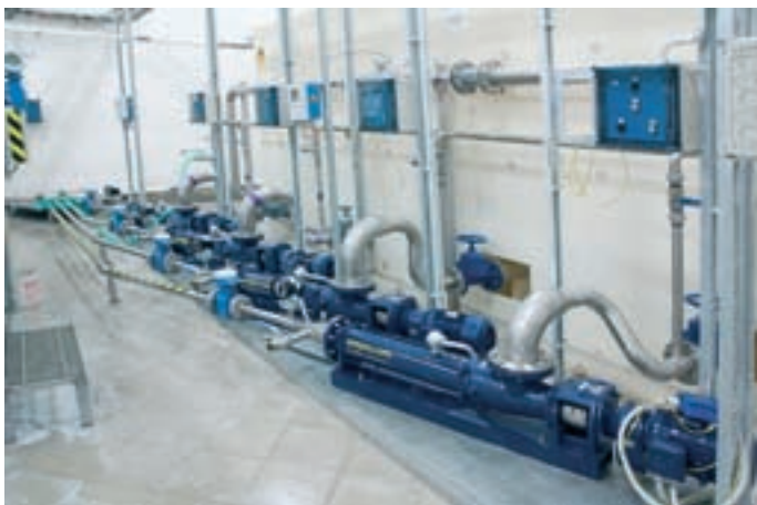
Obr. 4: Čerpadla kalu SEEPEX dopravující vápenné mléko z homogenizační nádrže do sytičů
