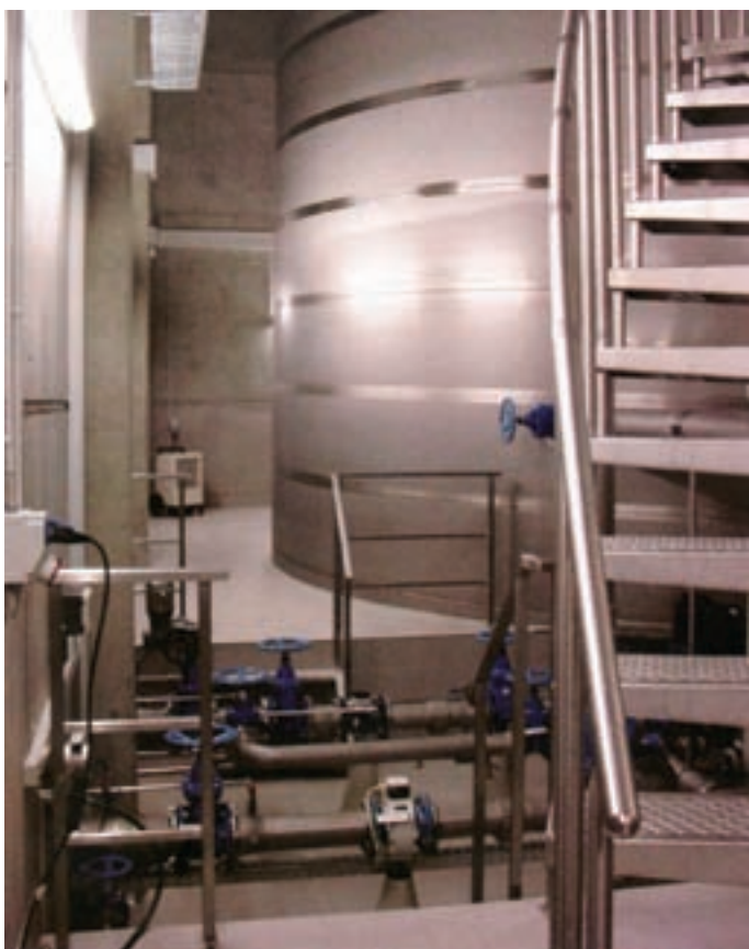
Obr. 1: Pohled do vnitřku budovy s instalací a vodojemem
