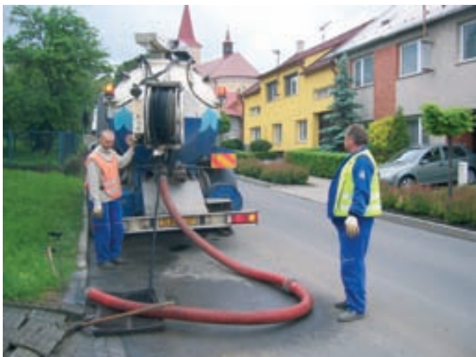
Kanalizační vůz Harben používaný střediskem Kanalizace Zlín
