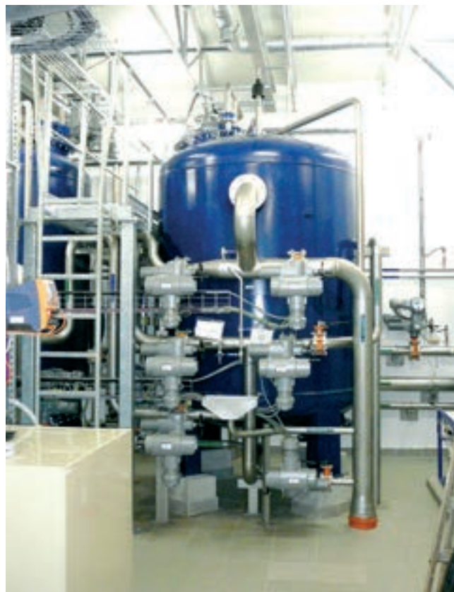
Obr. 2: Filtrace přes dva tlakové filtry
