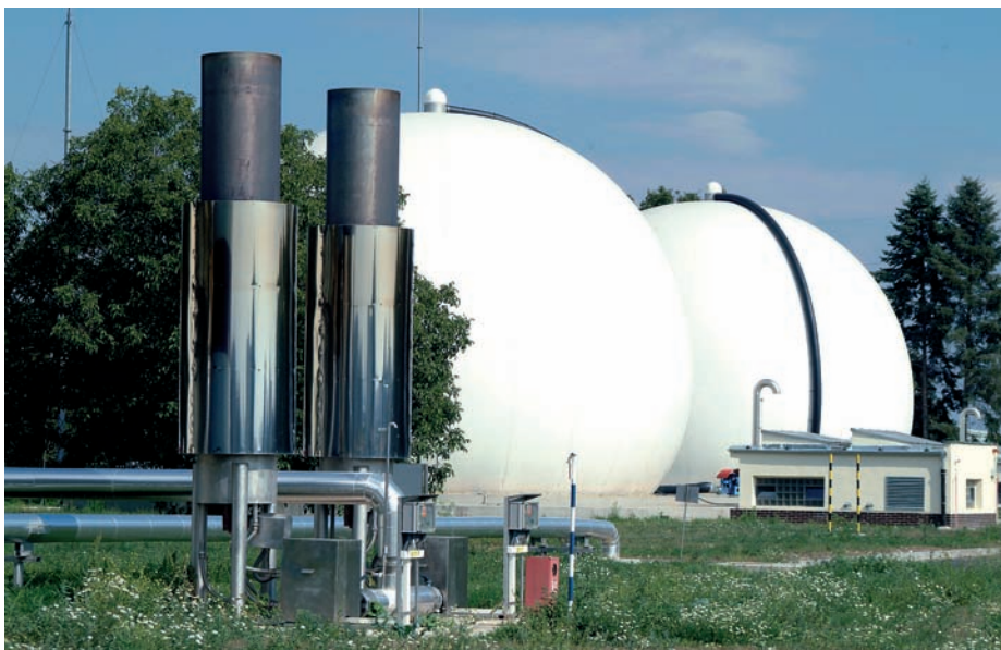
ČOV Brno-Modřice, plynové hospodářství
