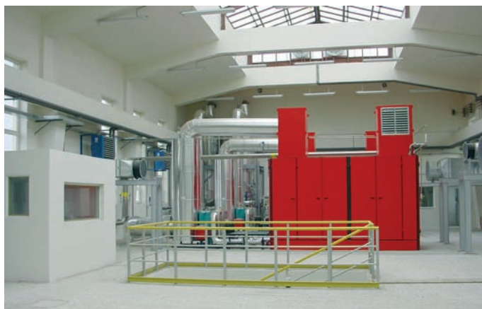
ČOV Brno-Modřice, kogenerační jednotka
