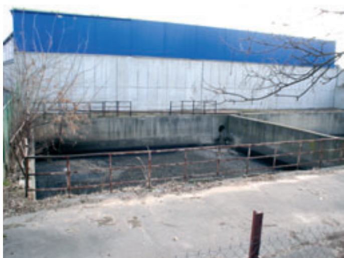
Obr. 3: Venkovní záchytné nádrže sloužící k akumulaci odpadní vody
