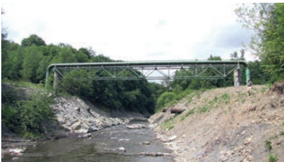
Obr. 6: Původní přemostění řeky Morávky (pohled po toku řeky). Vpravo jsou viditelné obnažené části zaslepeného potrubí původní dvouramenné shybky DN 800 (stav v roce 2011). Rozsah zahloubení řeky lze porovnat s velikostí postavy na pravé straně obrázku
