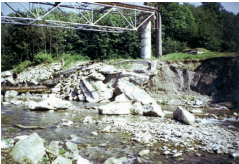
Obr. 4: Ohrožení levobřežní podpory původního přemostění po povodni v polovině devadesátých let (pohled proti toku řeky)
