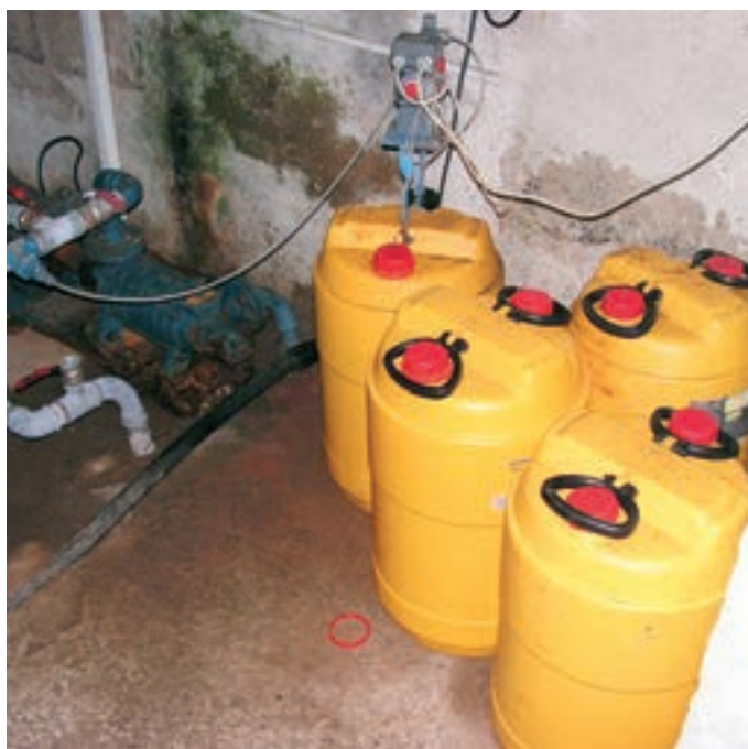
Obr. 2: Typický pohled do technického zázemí mnoha našich vodovodů (tento snímek konkrétně z jedné malé středočeské obce): nadbytečná zásoba chlornanu sodného v neklimatizovaných prostorách. Při doplňování zásobníku bývá nesprávně míchán nový chlornan sodný se zbytkem starého. Foto: autor
