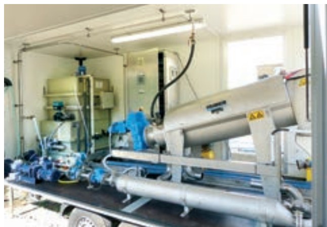
Mobilní odvodňovač kalů
