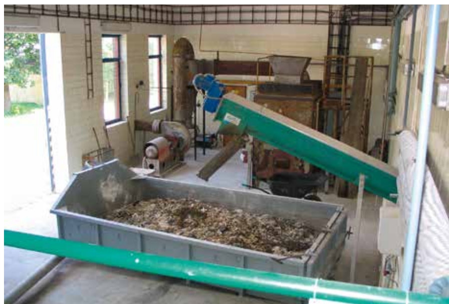
Na čistírnách odpadních vod vznikají v malém množství i odpady, které nejsou čistírenskými kaly. Na snímku z ČOV Malenovice jsou shrabky, zachycené před vstupem do technologie.
