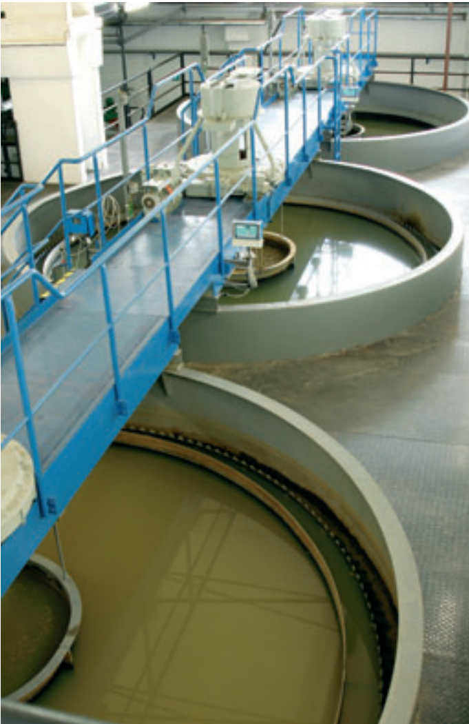
Úpravna vody Švařec – kalové hospodářství
