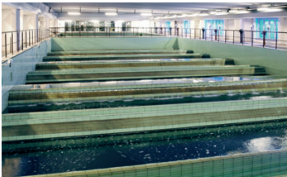
Úprava vody Švařec – filtry
