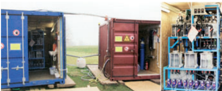
Obr. 3: Kontejner pro zámořskou přepravu s nainstalovanou poloproduční úpravnou vody s keramickými membránami (vlevo) a předoxidace (vpravo)
