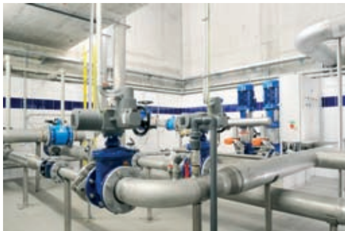
Obr. 11: Vodojem Březí, technologie
