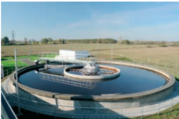
Obr. 5: Úpravna vody v Lednici – klariflokulátor
