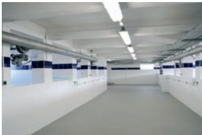
Obr. 6: Úpravna vody v Lednici – hala filtrů
